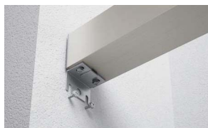
基準となる位置に墨出しを行い、コーチねじを外壁面より18~20mmほど出した状態で仮止めする。
